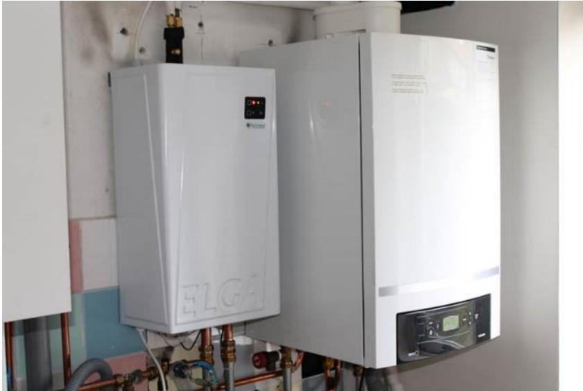
Warmtepomp (links) en cv-ketel (rechts)
